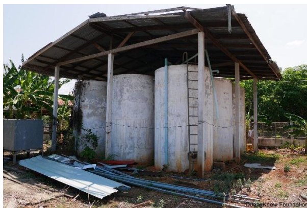
ถังเก็บน้ำบางถังชำรุด ใช้งานไม่ได้ หลังคาผุพัง
